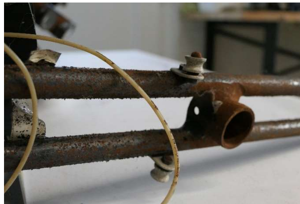
Bild 3. Der Befestigungsbügel ist ebenfalls korrodiert. Die Beschichtung ist entfestigt und steht in Schollen ab. Der Antriebsriemen zeigt die Positionierung des Antriebsmotors.
